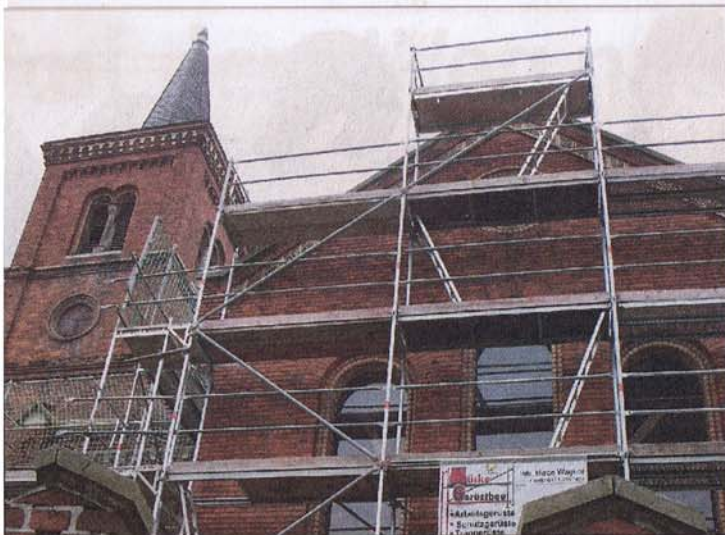
Das Gerüst steht, es kann losgehen mit der Sanierung der Kirche. Architekt Michael Ewerin (links) erläuterte gestern die Bauarbeiten.
