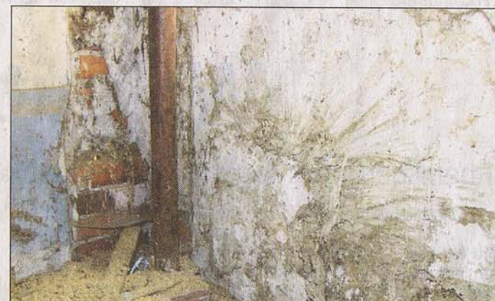
Der Sporen des Schwammes fressen sich durch die Mauern. Im Inneren der Kirche bleibt viel zu tun. Fotos (4): Rachner
