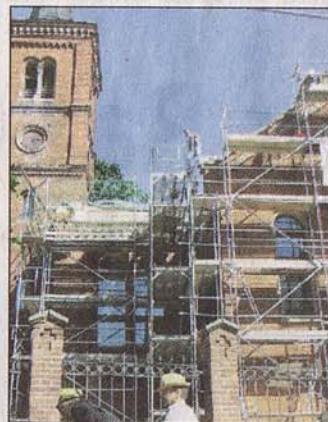
Die Dorfkirche ist bis auf den Turm eingestüstet.
